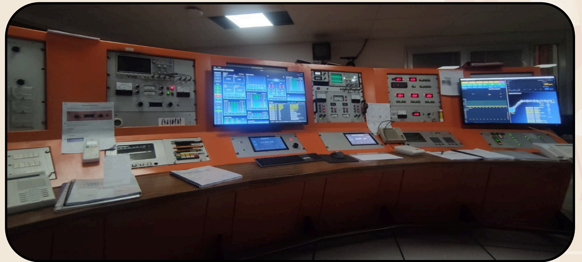
Salle de controle
